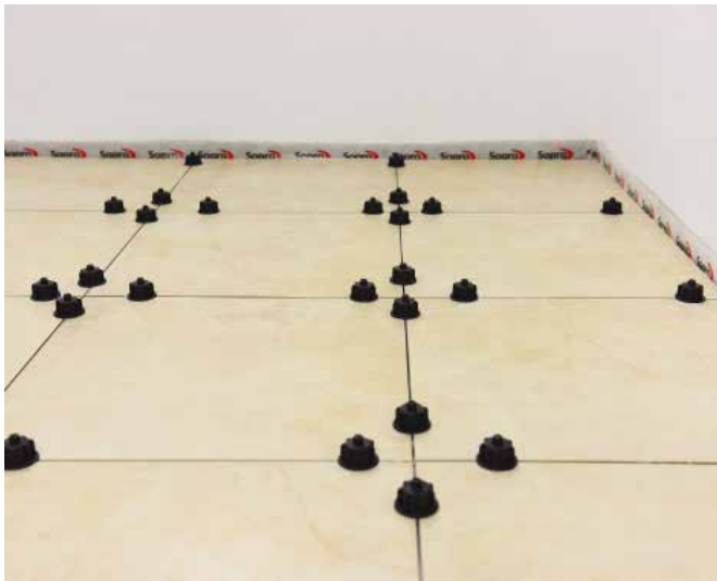
7 Verlegtes Sopro Großformat-Nivelliersystem. Der Laschenverbrauch variiert je nach Größe der Fliesenformate. Je größer das Format, desto weniger Laschen werden benötigt.
